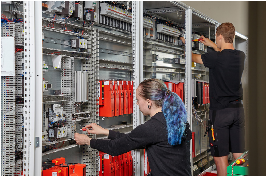
Schaltschränke und Bedienpult werden in der eigenen Elektro-Werkstatt gefertigt.
